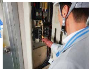
電気設備点検
