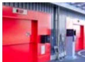
立体駐車場開閉扉
